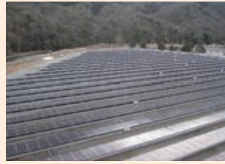
西脇太陽光発電所
