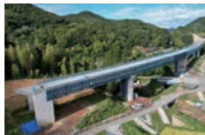
工事名称 令和3年度 三隅・益田道路馬橋高架橋鋼上部工事 発注者名 国土交通省 中国地方整備局
