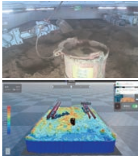
図-1 地盤計測システムによる地下空間の3Dデジタルツイン(上: 地下空間、下: 地上可視化画面) 提供: 株式会社DeepX
