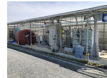
パイロットプラントメタン発酵システム
