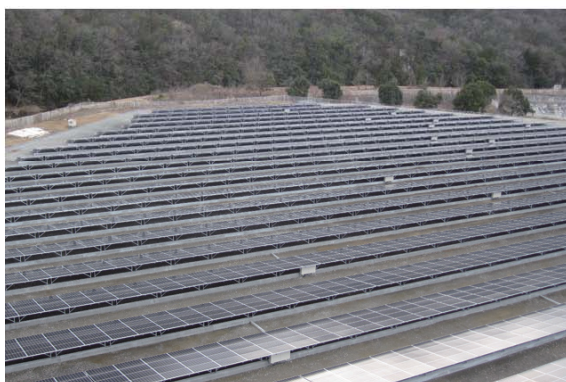
西脇太陽光発電所
